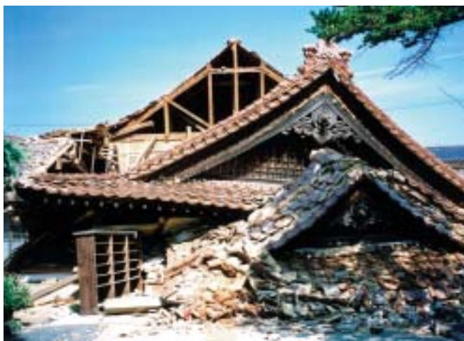
地震で倒壊した出雲大社境港上道分院
